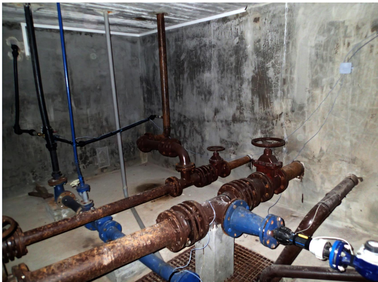
Armaturní výstroj v suterénu vodojemu
