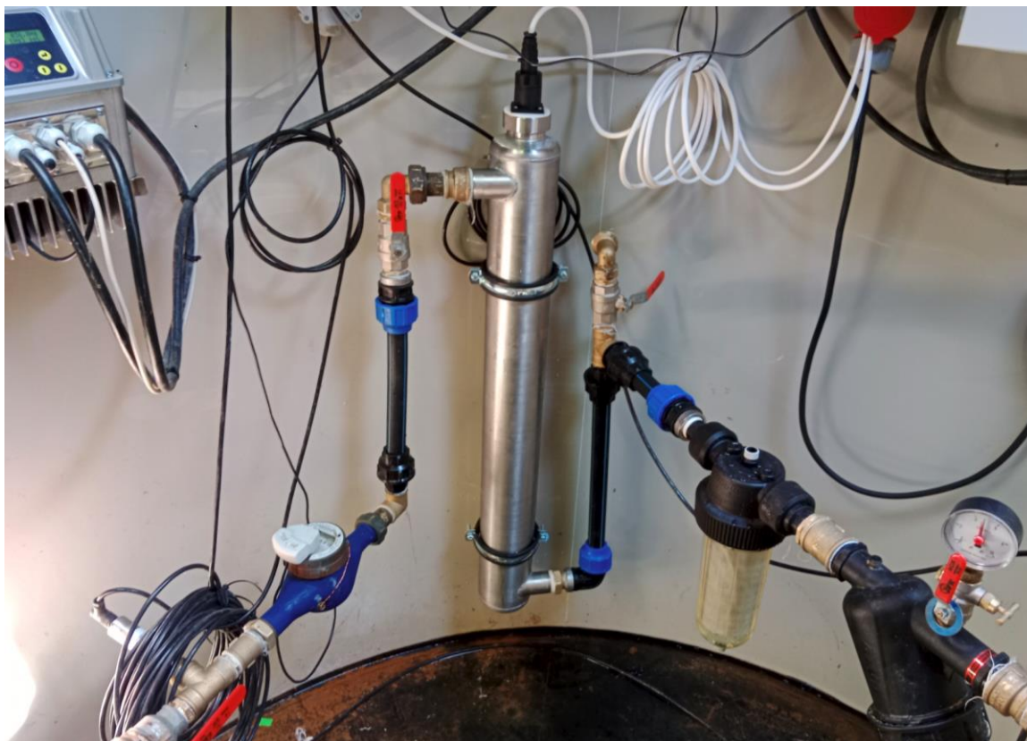
Osazená UV lampa s filtrem na vrtu HV1B
